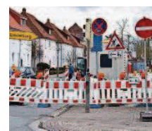
Der Oldenburgisch-Ostfriesische Wasserverband lässt in einem Teilabschnitt der Viktoriastraße eine neue Trinkwasserleitung verlegen. Foto: Kühnemuth
